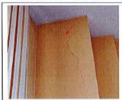
Fig. 22 – Fisura în pereții interioari – interior corp A
