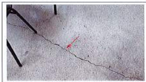
Fig. 23 – Fisura în mozaicul salii cu cupola – corp A
