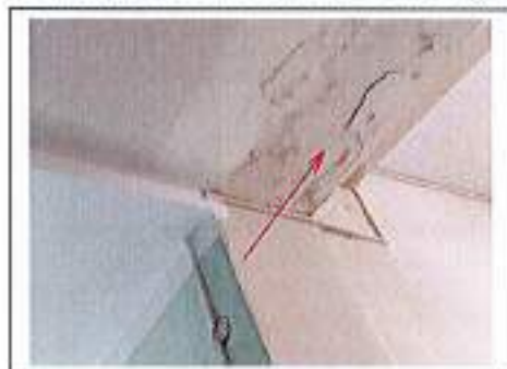
Fig. 26 – Tencuiala interioara desprinsa datorita infiltratiilor de apa (interior corp A)
