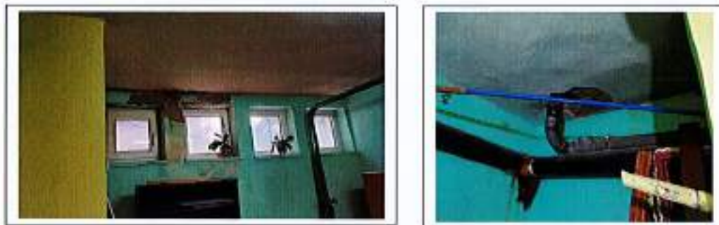
Fig. 24 – Tencuiala interioara desprinsa (susol corp A)
